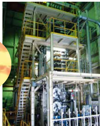
横須賀にある マルチバーナー燃焼試験炉
